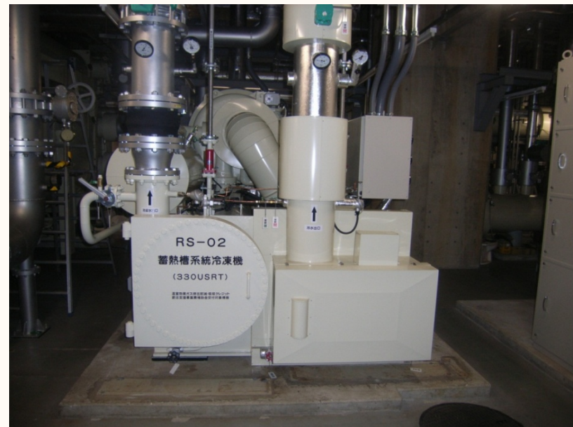
ターボ冷凍機(更新後)
