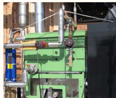
▲ペレットボイラー
